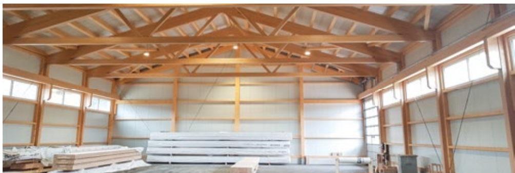
Poutrelle extrêmement fine comprenant des chemins de roulement de grue en bois de hêtre à haute performance dans la halle des produits finis nouvellement construite sur le site des Breuleux
