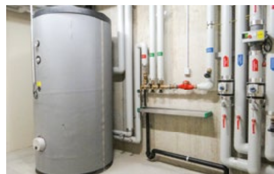
Wohlen AG, Überbauung Steindler: Wärmeübergabestation für ein Mehrfamilienhaus Quelle: Holzenergie Schweiz, Christoph Rutschmann
