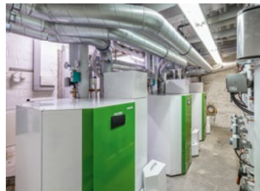
Kompakt und sauber: Heizzentrale für die katholische Kirche und das Pfarreizentrum Lenzburg Quelle: Braunschweiler Pellets AG
