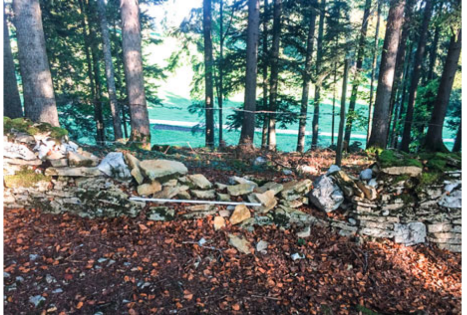
Le mur cassé
