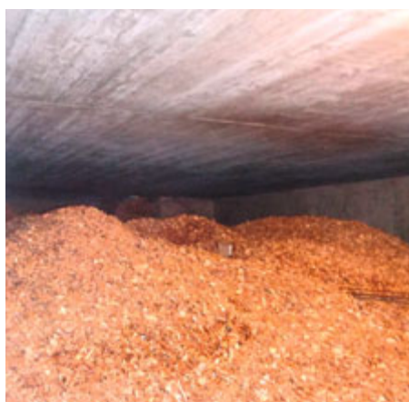
Silo du chauffage à bois de la Résidence Les Roches à Orvin. (C. Gassmann)
