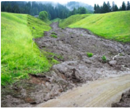
Abbildung 4: Der Fließweg der Hangmure vom 3. Juni war deutlich zu erkennen. Blick vom Studweidli aus hangaufwärts entgegen der Fließrichtung.
