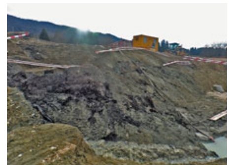
Bordure est du glissement Source Ch. Bugnon, MFR Géologie-Géotechnique SA Bienne
