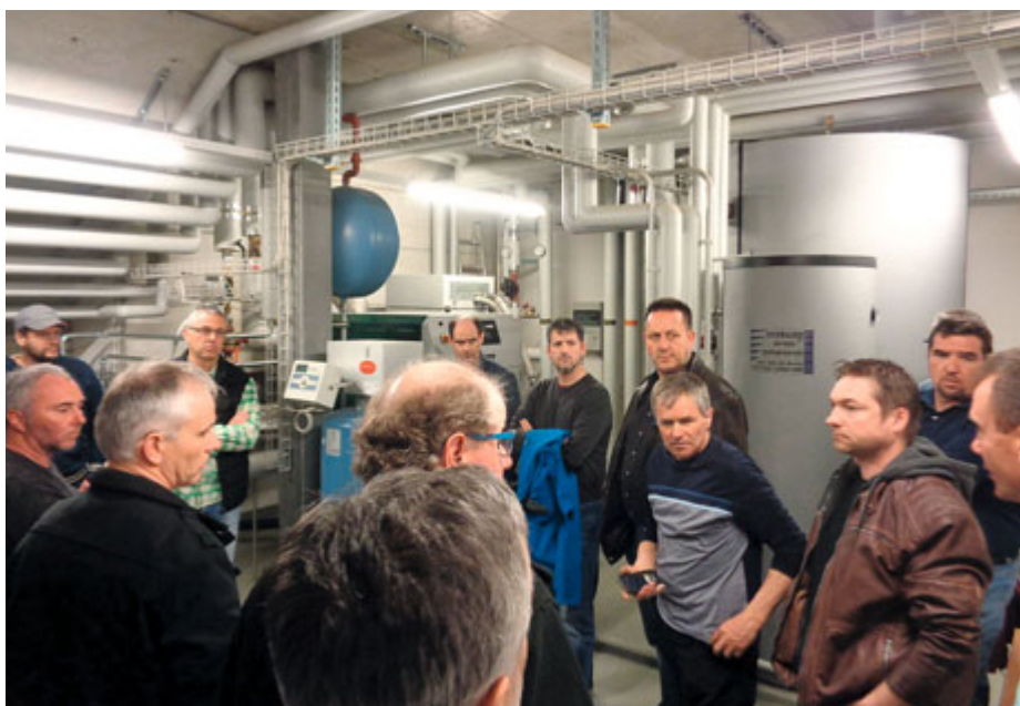
Visite de l'installation de chauffage aux pellets Source: Claude Gassmann
