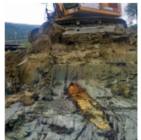
Tronc retiré au km 64'325 Source Ch. Bugnon, MFR Géologie-Géotechnique SA Bienne
