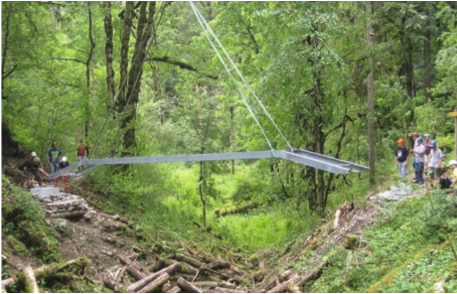
Transport hélicoptéré et mise en place de la passerelle photo Bertrand Girardin.
