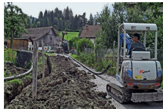
Mise en place d'un tuyau pour le chauffage à distance de Sorvilier (Photo Henri Burkhalter)
