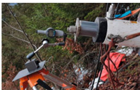
Essai de traction pour contrôler la solidité, le dimensionnement et la qualité de l'ancrage (Photo D. Linder)
