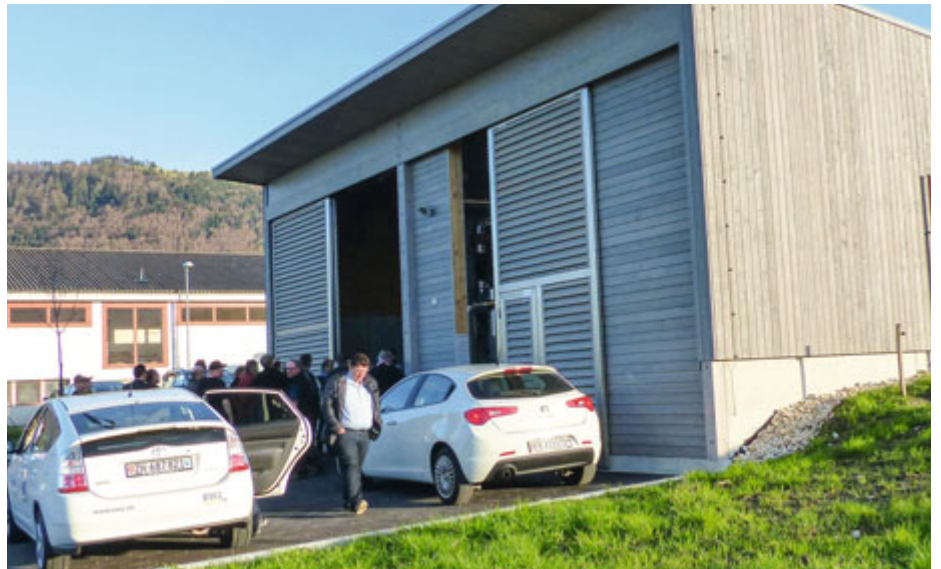
Nouvelle installation de chauffage à distance aux copeaux de bois de Tavannes
