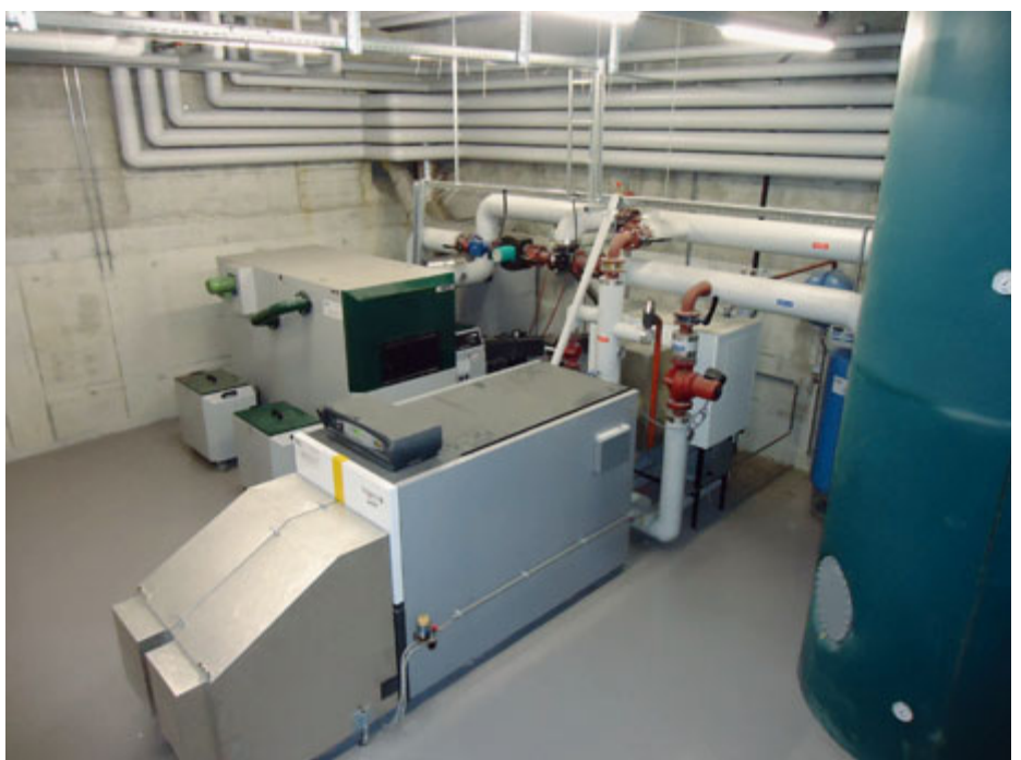
Local et installation du chauffage à distance (Photo du bureau ECE, Moutier, M. Gsteiger)
