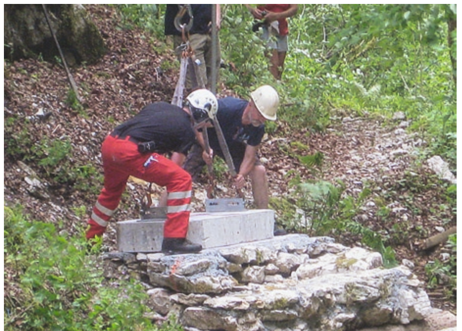
Mise en place d'un des socles de la nouvelle passerelle dans le haut de la Combe de Biaufond photo Bertrand Girardin.
