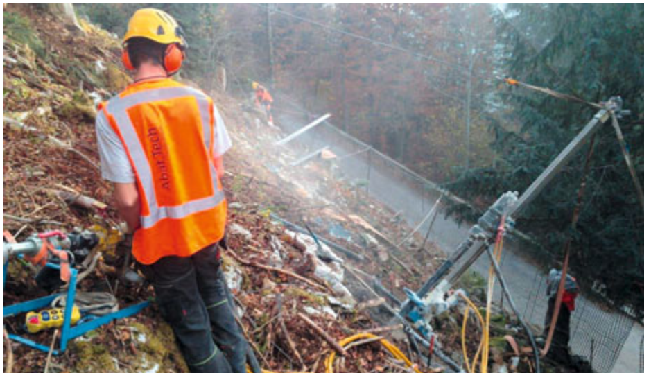
Machine de forage légère avec un faible impact sur la nature pour un diamètre d'ancrage du filet de protection de 90 mm. (Photo D. Linder)
