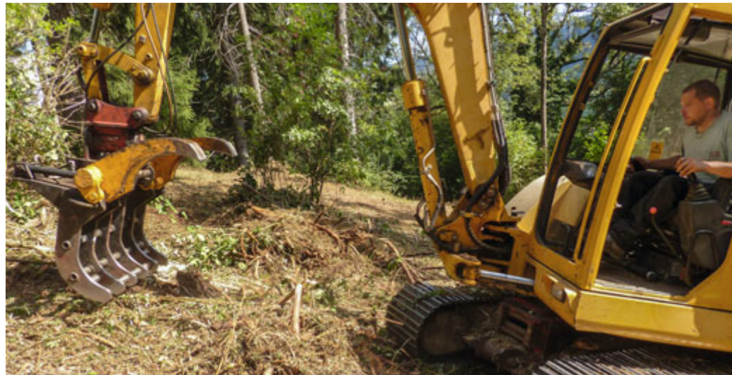
Nettoyage grossier du sol par Michel Tschanz et le râteau hydraulique monté sur le bras de sa machine
