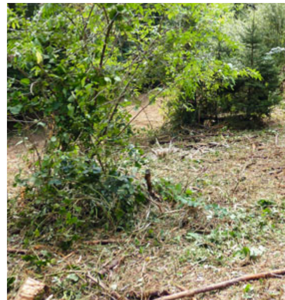
Résultat après les travaux. Le débroussaillage est effectué, les endroits définis préalablement sont sauvegardés.
