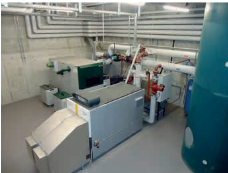
Local et installation du chauffage à distance (Photo du bureau ECE, Moutier, M. Gsteiger)
