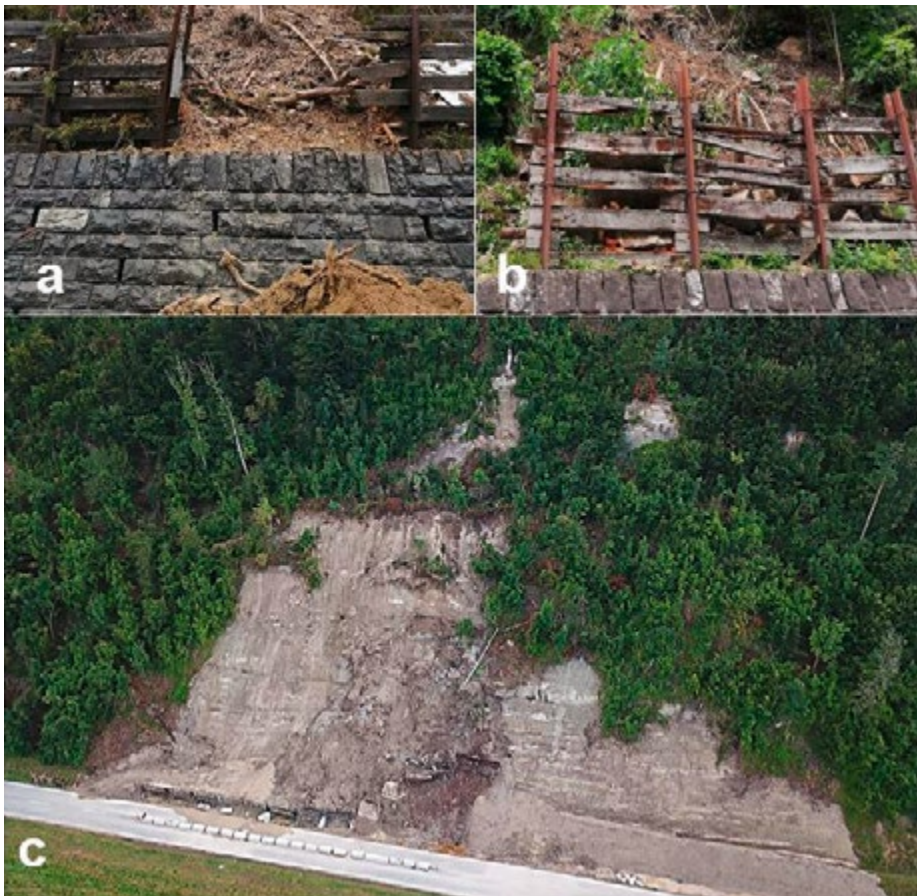
Illustration 3 : Glissements de terrain sur des routes cantonales à (a) Laupen, photo : D. Bolliger et (b/c) entre Weissenburg et Oberwil, photos : Tom Ninck
