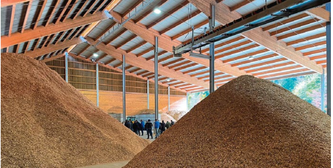
In der Holzvergaseranlage der Lignocalor AG in Gasel werden jährlich 1000 MWh Strom und 3000 MWh Wärme produziert
